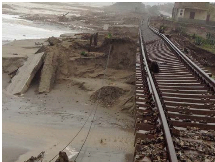
Novembre 2015. Evento alluvionale a Ferruzzano Marina
