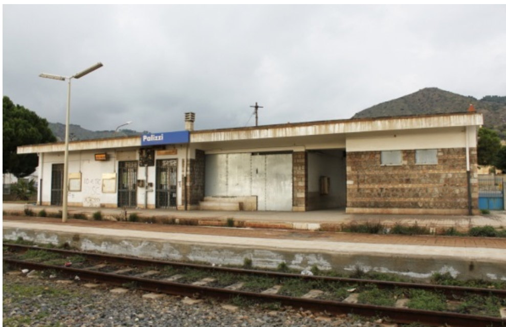
Condizioni di degrado delle stazioni. Stazione di Palizzi
