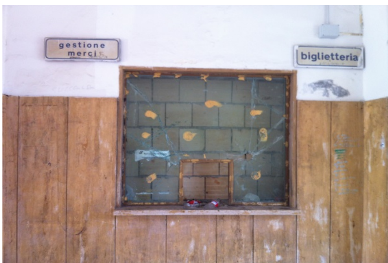
Condizioni di degrado delle stazioni. Stazione di Ardore.
