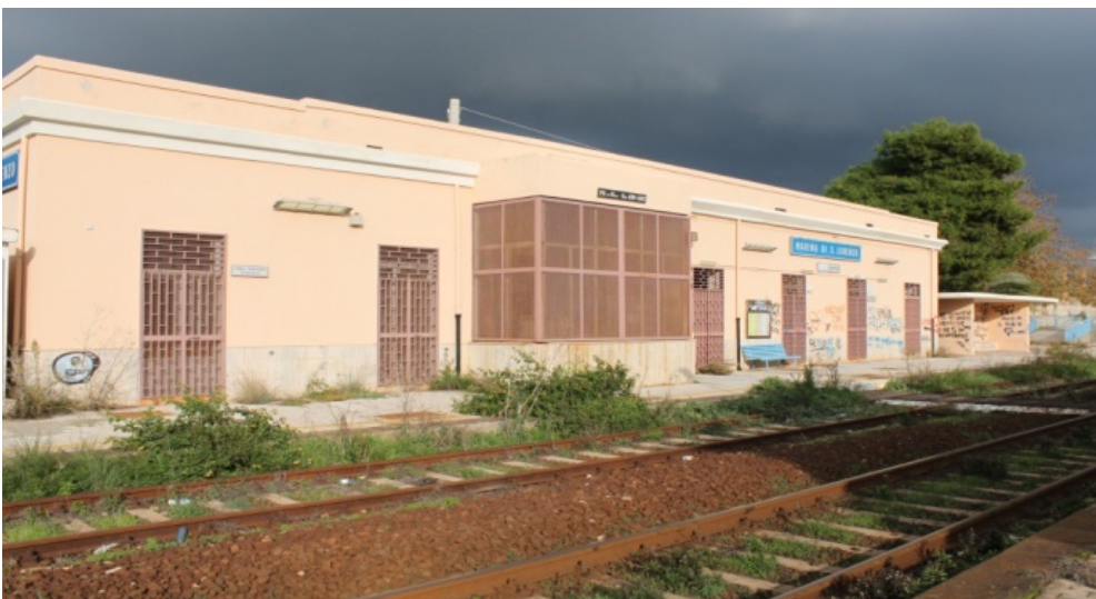
Condizioni di degrado delle stazioni. Stazione di Marina di S. Lorenzo
